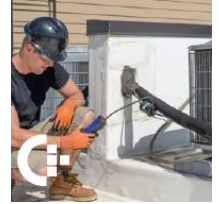
Détection de fuites
